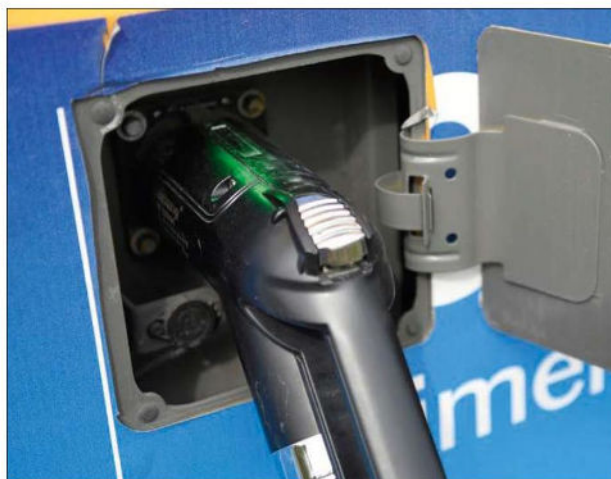
Opladning af elbusser hos Umove finder sted fra 10 ladestationer, som kan oplade to busser ad gangen, så alle 20 busser kan oplades samtidigt hvis nødvendigt.
